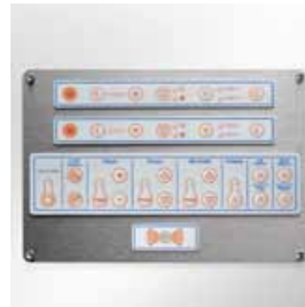
Pannello di controllo a parete
